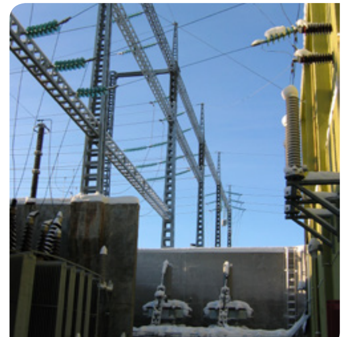
Transformatorstasjonen i Varangerbotn.
