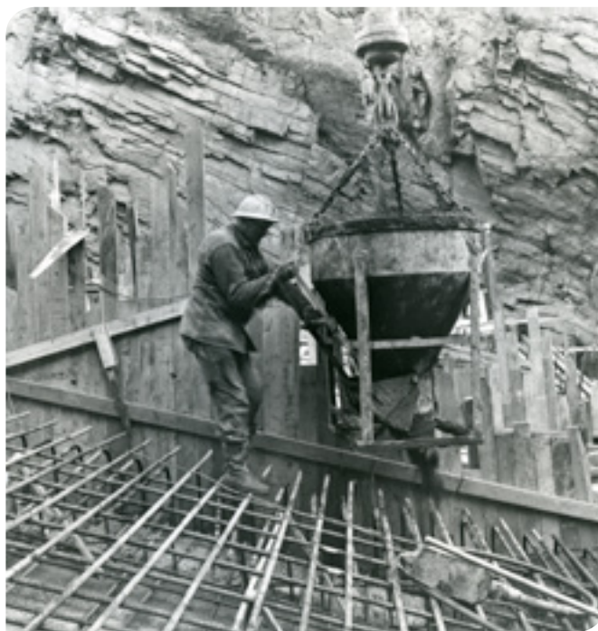
Skogfoss kraftstasjon ble satt i drift i 1964. Her er et bilde fra anleggsperioden.
