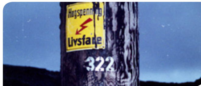
Alle kraftstolper er merket både med nummer og det velkjente merket "Høyspenning livsfare".
