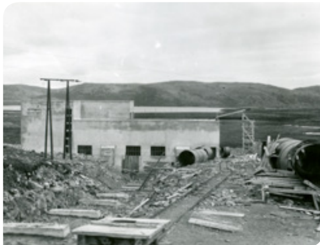
Kongsfjord kraftstasjon under bygging. På bildet ser man at det er støpt fundamentet for rørgata, men at den ennå ikke er montert. Bildet er fra slutten av 1930-tallet.
